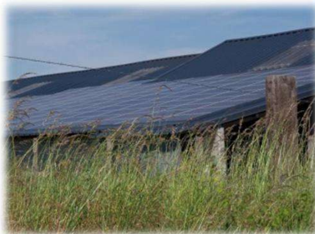
Toiture photovoltaïque sur un bâtiment d'élevage au Marillais
