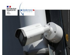
Mise en place de la vidéoprotection
