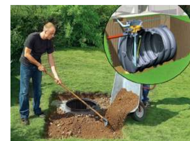
Cuve de récupération enterrée
